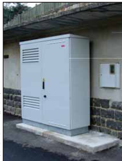
L'armoire implantée sur la place publique du Pont de Fromentières.
