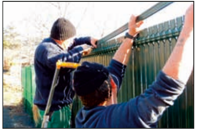
Si l'équipe technique intervient ponctuellement sur des chantiers, comme ci-dessus avec la pose d'occultants, elle veille toute l'année à l'entretien et à la propreté de la commune.
