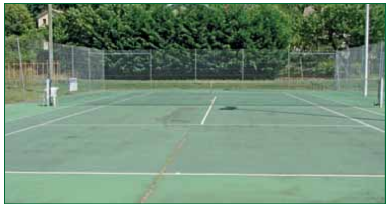
Les fissures du court de tennis colmatées pour l'été.
